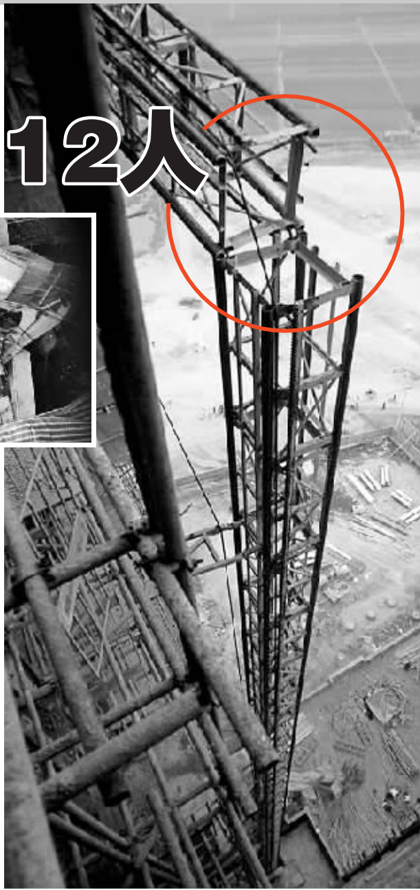
在建3号楼23层处电梯井架折断。
