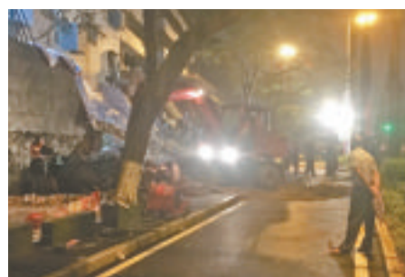
■相关人员对垮塌处进行紧急处理。
